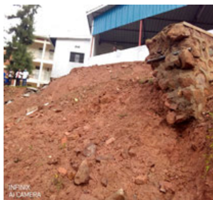
Hangabrutschung Mai 23 Murunda-Hospital
